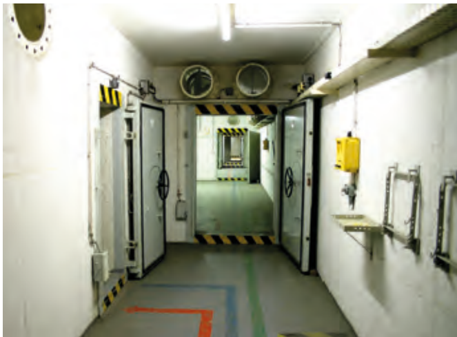
Schleusenbereich im Personal- und Technikbereich.
