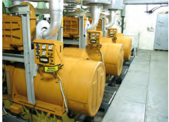
Netzersatzanlage mit drei Dieselgeneratoren.
