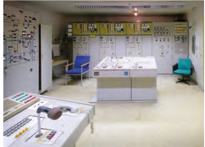
Dispatcherzentrale mit Schaltschränken und Schaltpulten.
