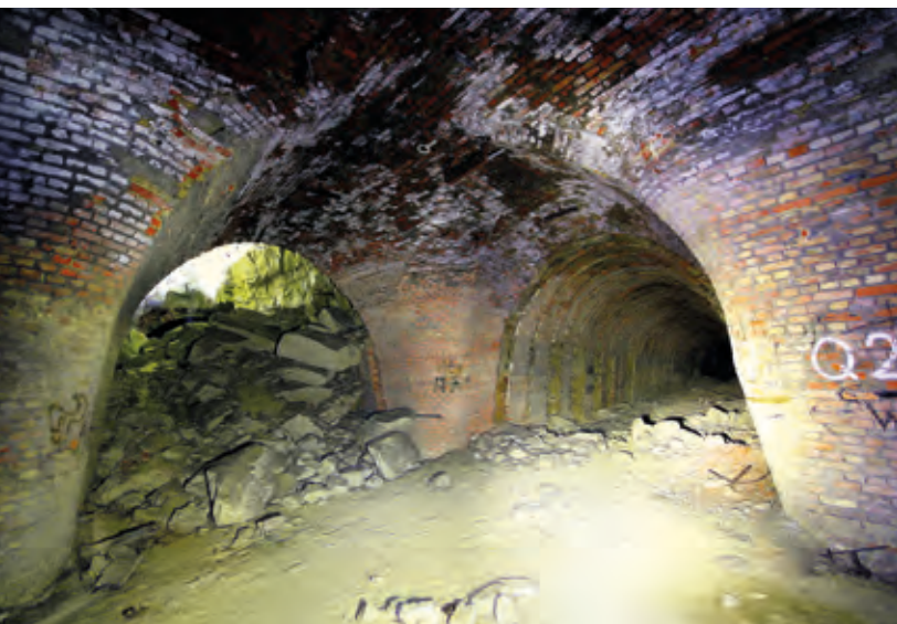
Weite Teile der westlichen Anlage sind infolge der Sprengungen verschüttet.
