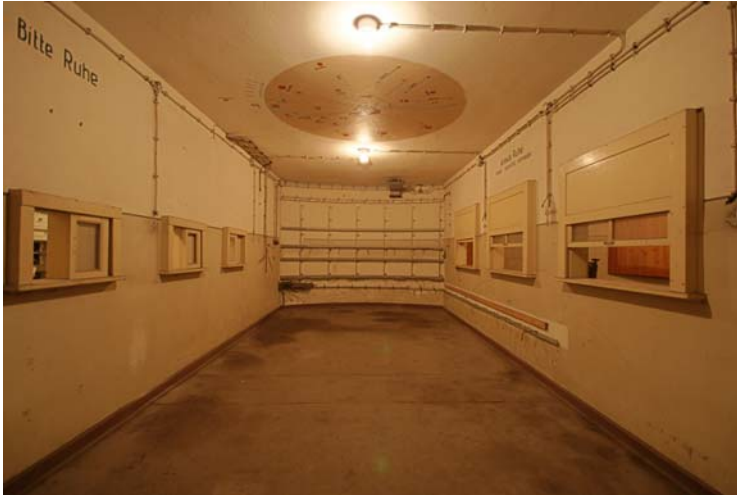
Abbildung 35: Erdgeschoß, Befehlsstelle: Blick in den Raum. An der Rückwand Gestelle für Fernmeldetechnik
