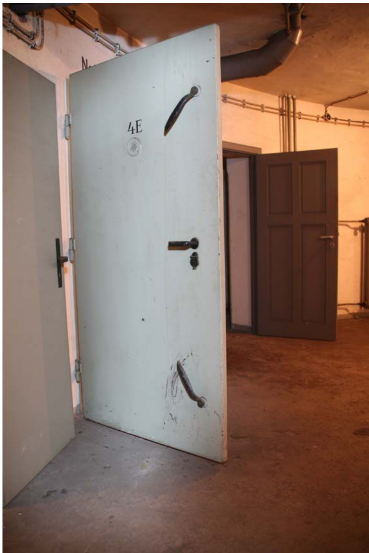
Abbildung 56: Aufenthaltsraum 4. Stock: Gasschutztür
