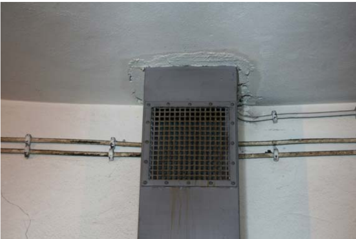
Abbildung 58: Detail: Zuluftkanal in den Aufenthaltsbereichen
