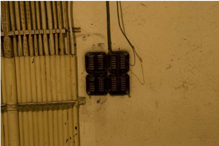
Abbildung 53: Aufenthaltsraum 3. Stock: Kabelbaum und Fernmelde-Anschlussfeld
