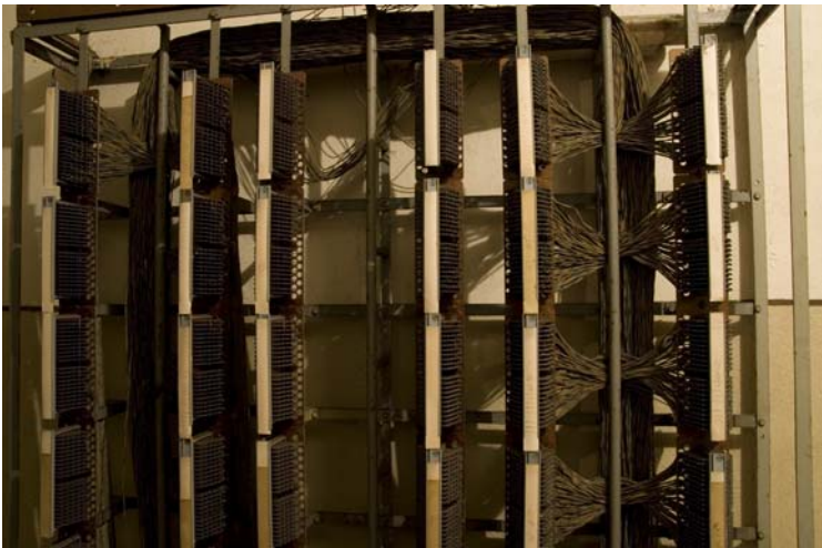
Abbildung 42: Erdgeschoß, Telefonraum: Fernmelde-Anschaltfeld
