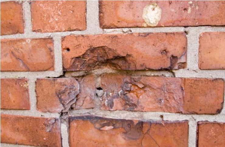
Abbildung 9: Mauerschaden, wahrscheinlich durch Splitterwirkung
