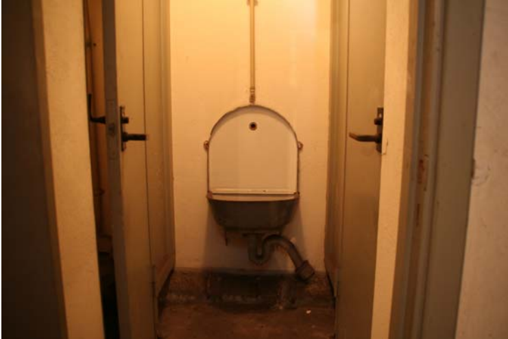
Abbildung 45: Waschbecken in einem Abort-Vorraum
